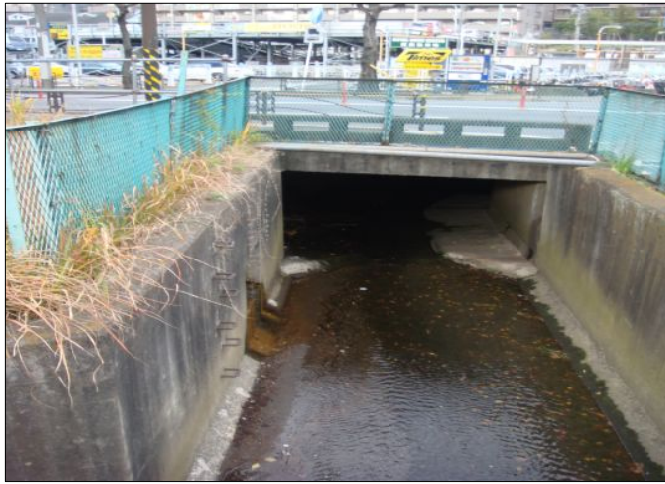
写真は、宮前平駅近くの矢上川。豪雨の時には水面が上がり、橋の上を通る尻手黒川道路が冠水してしまいます。
